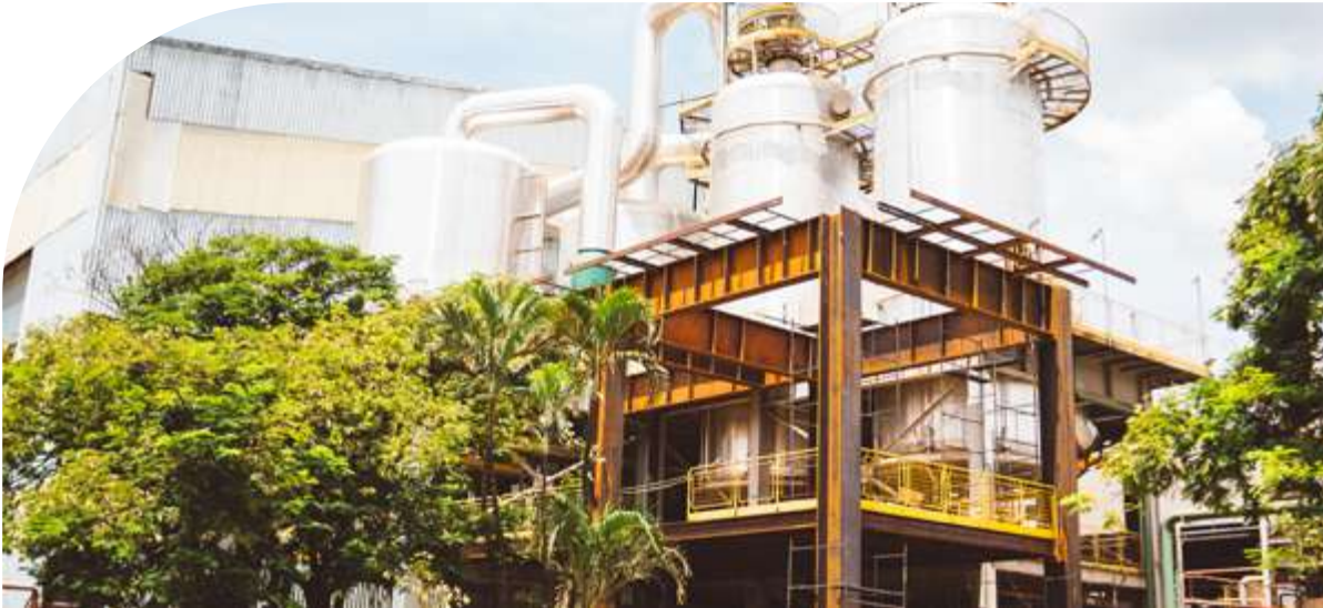
Cozedor e pré-evaporadores, e, na frente, estrutura para novos evaporadores e cozedores para a safra 24/25 (Fábrica de Açúcar)
